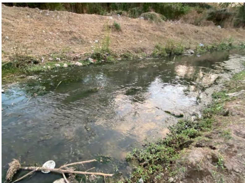
Figura 9. Se observa la salida de las aguas fecales por rotura de la tubería y numerosos vertidos sólidos, colonia Asentamientos humanos.
